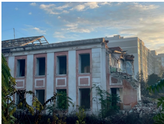
Рис. 12. Загальний вигляд руйнування об'єкта внаслідок влучання снаряда
