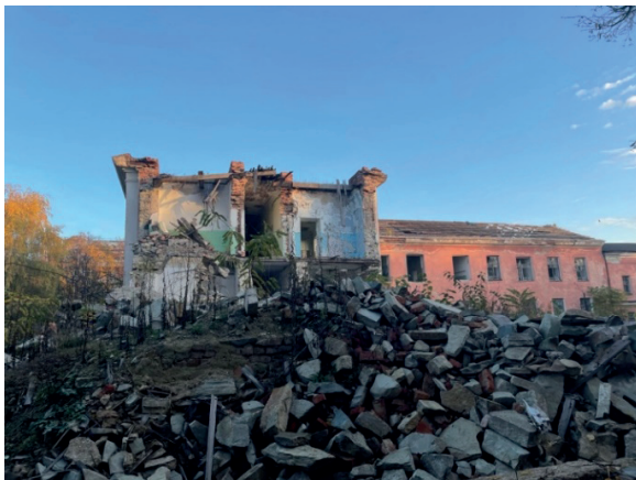
Рис. 13. Загальний вигляд руйнування об'єкта внаслідок влучання снаряда
