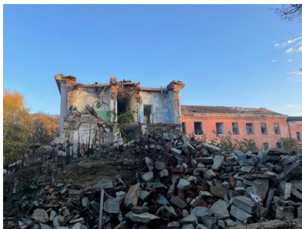
Рис. 12. Загальний вигляд руйнування об'єкта внаслідок влучання снаряда
