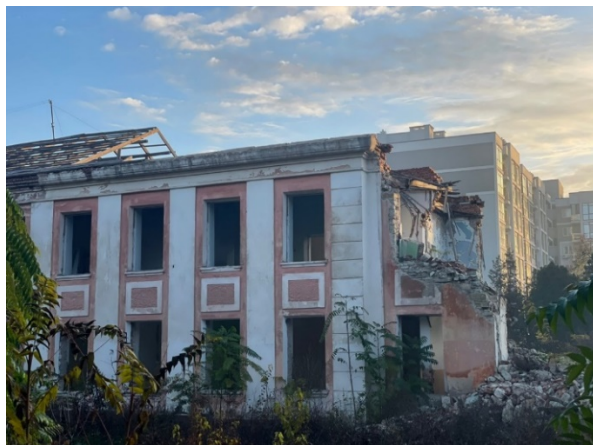
Рис. 11. Загальний вигляд руйнування об'єкта внаслідок влучання снаряда
